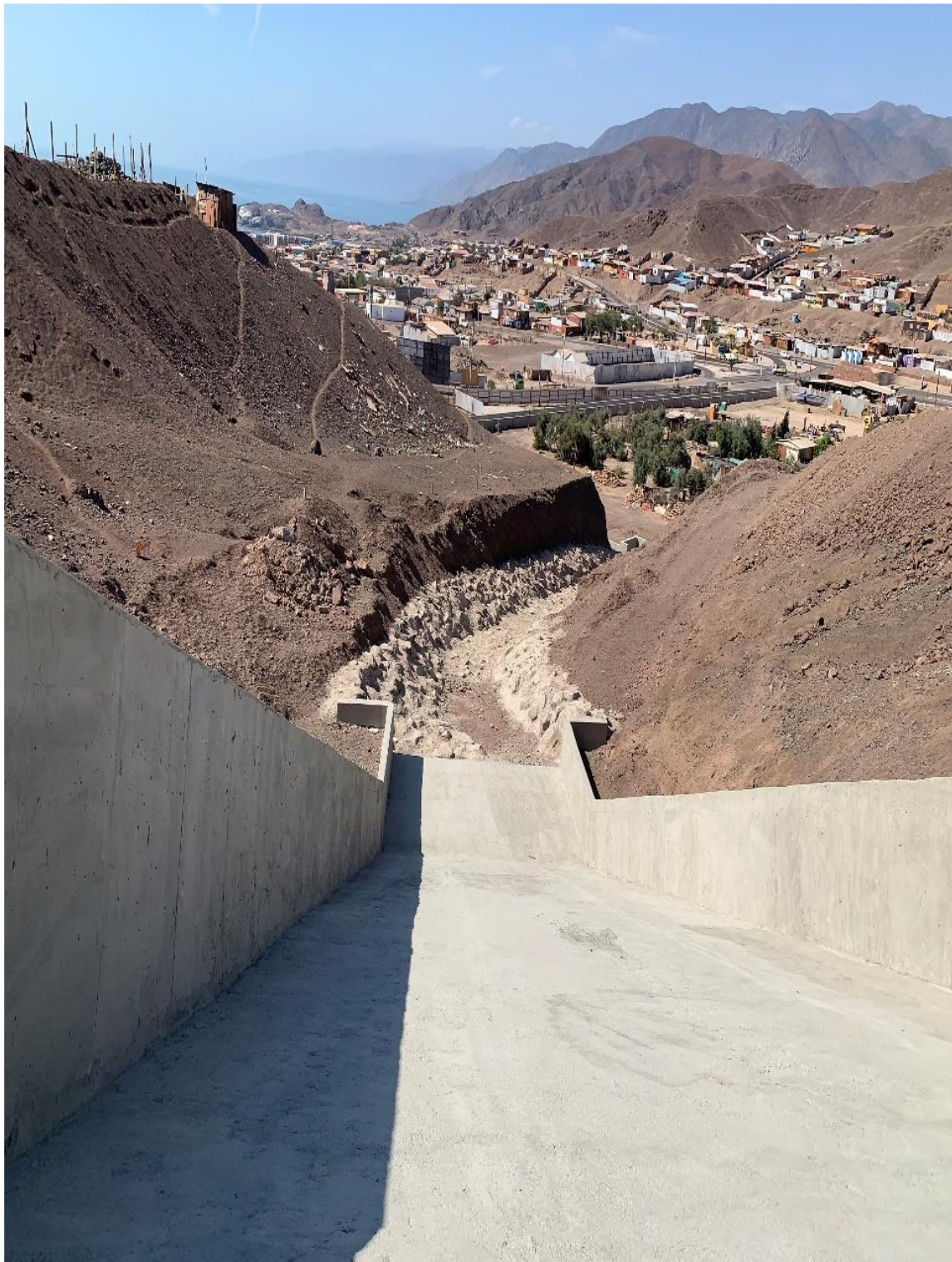
Construcción Obras de Control Aluvional en Quebradas, Sectores República y Tiro al Blanco, ciudad de Taltal.
