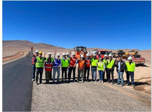
Camino Básico por Conservación, Ruta S/R Acceso Cerro Ventarrones, Provincia de Antofagasta.
