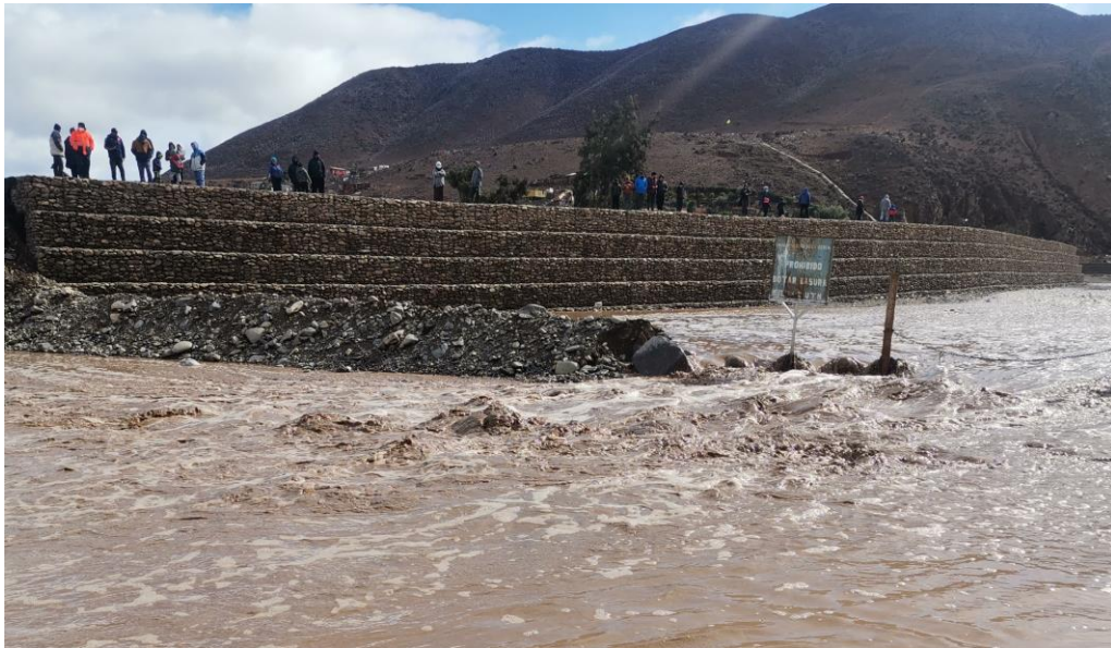
En la imagen las obras ejecutadas en quebrada de "Santa Gracia" y su labor de protección en las pasadas lluvias del mes de julio del 2022
