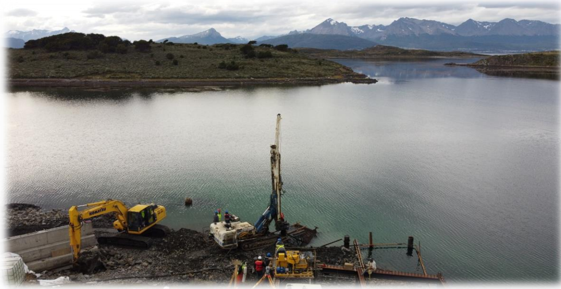
Obras de construcción de infraestructura Portuaria en Puerto Navarino (término de obras marítimas)
